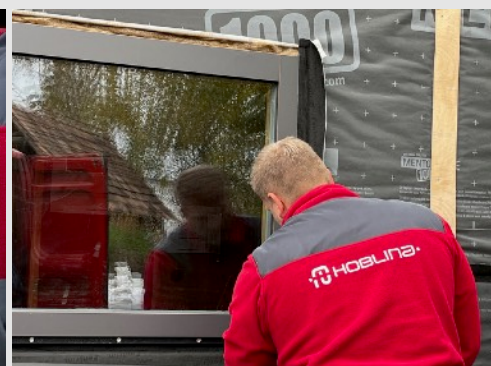
Keď je okno zafixované do ostenia, inštalačná medzera sa vyplní povrazcom z ovčej vlny.
